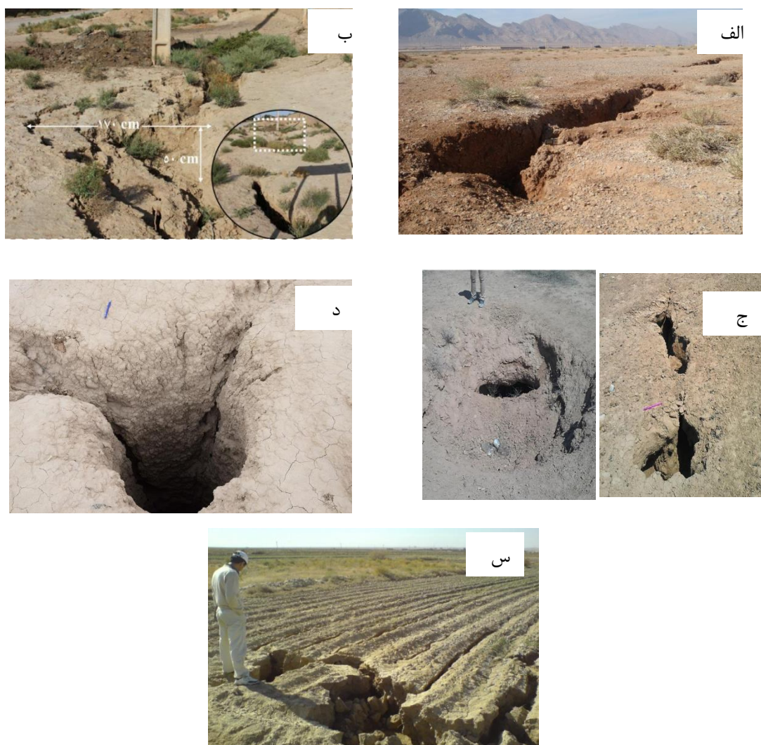
شکل ۷- فروچاله‌ها و نشست زمین در ارتباط با تخلیه‌ی آب‌های زیرزمینی در الف) دشت مهبیار (صالحی و همکاران، ۱۳۹۱)، ب) دشت دامغان (افضلی، ۱۳۹۱)، ج) دشت ایوانکی-استان سمنان (محمد نژاد، ۱۳۹۵)، د) دشت رفسنجان (شاهی دشت و عباس نژاد، ۱۳۹۰) و س) دشت نیشابور (دم‌شناس، ۱۳۸۸)
